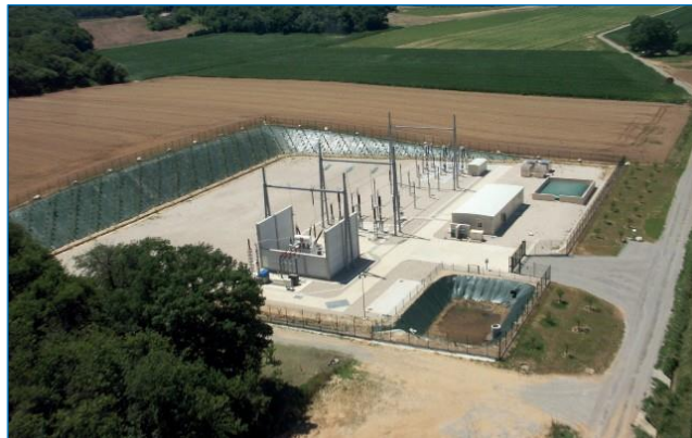
Exemple d'un poste aérien
