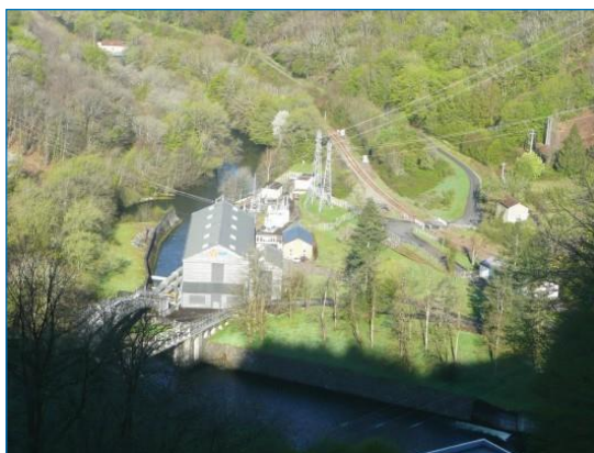
Poste de LAVAL DE CÈRE I
