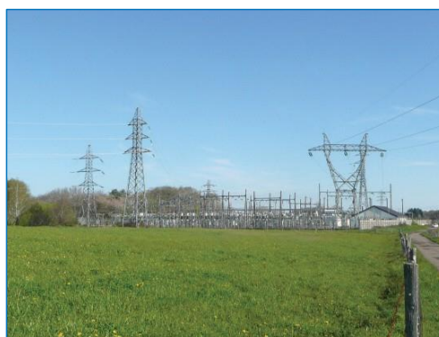
Poste électrique de TALAMET
